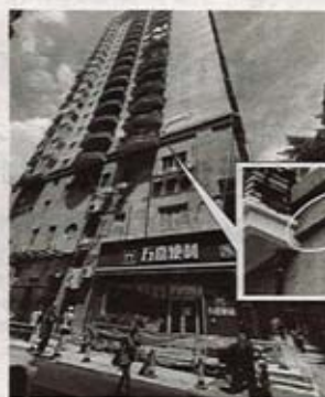
外墙瓷砖脱落,下方常有居民经过
